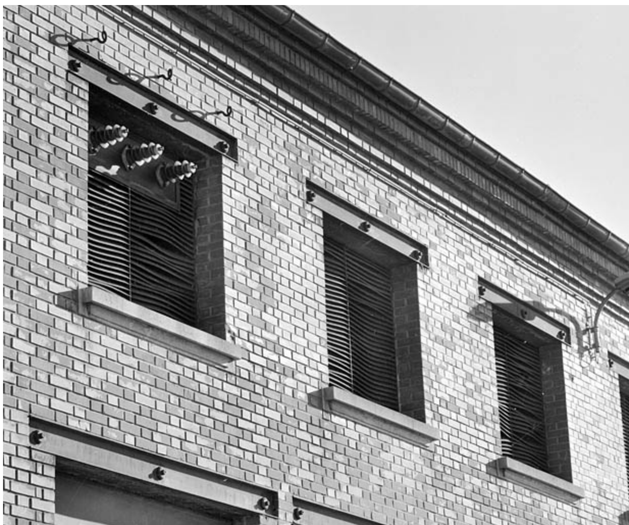
Transformateur : détail des baies supérieures.
