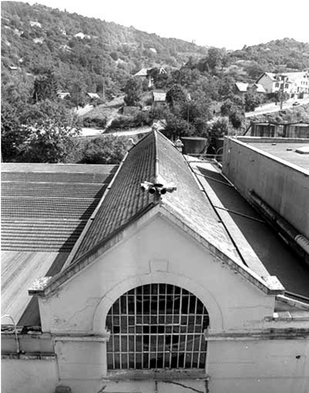
Chaufferie vue depuis le bâtiment de la 1ère filature tergal [TF1].
