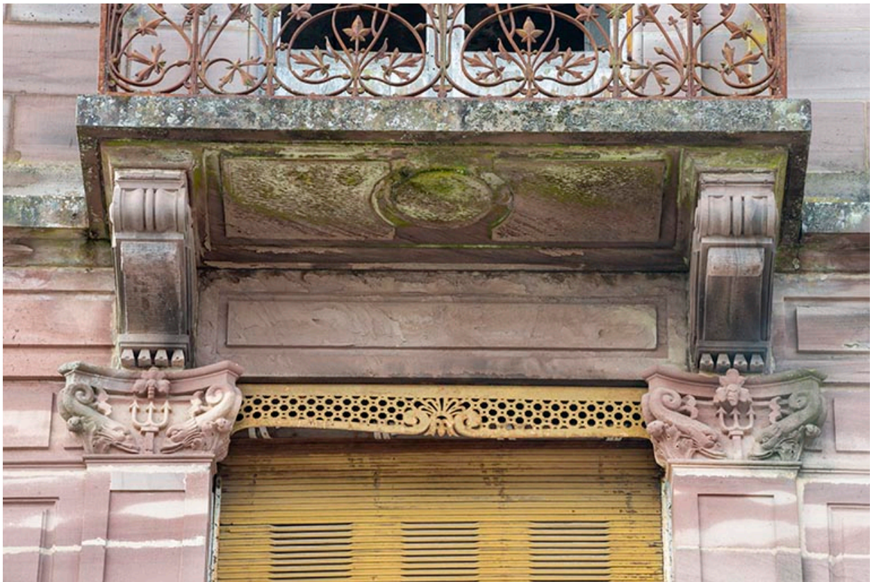
Façade du corps principal sur la rue des Thermes, détail.
