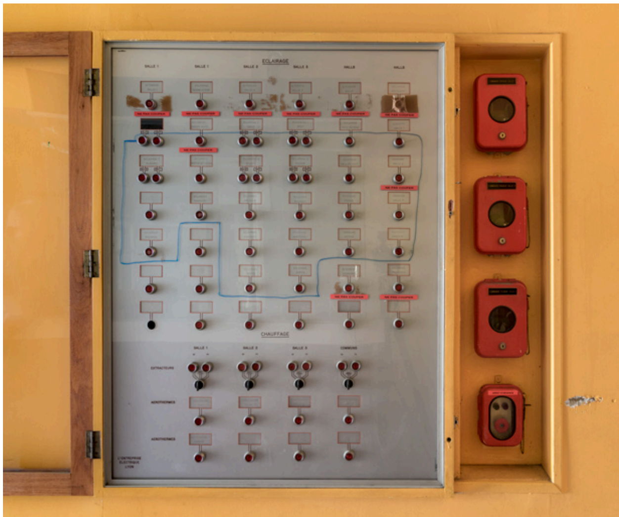
Cinéma : tableau de commande électrique dans le vestibule.
