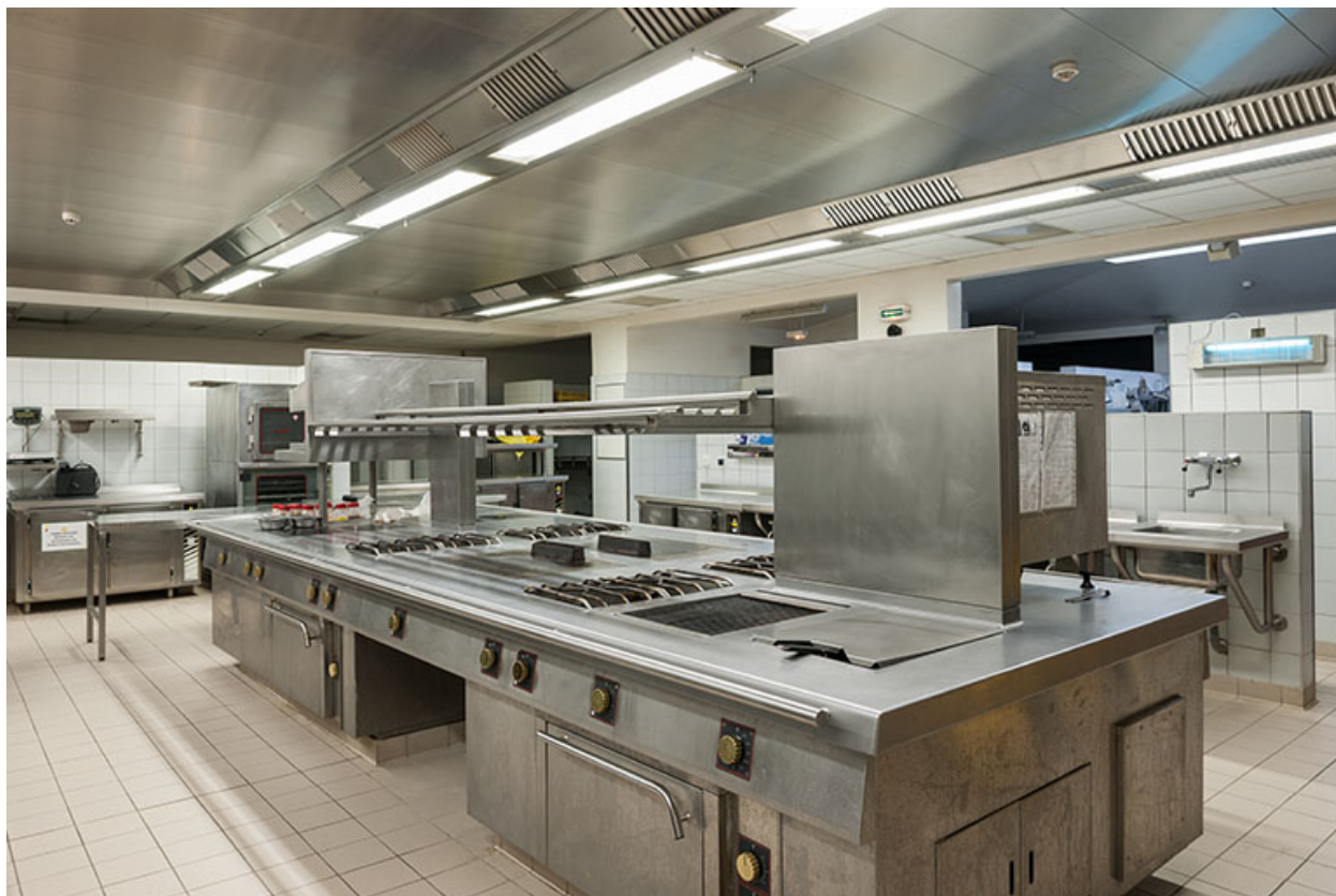
Cuisine du restaurant d'application.
