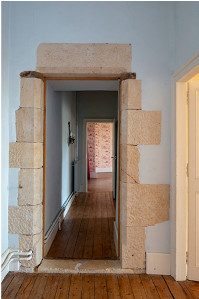
Premier étage du corps principal, porte séparant les deux parties constitutives (vue vers l'est).
