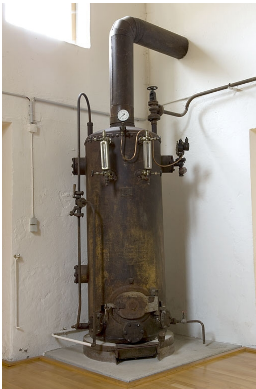
Salle de distillation. Chaudière Thiébaud (Tréviillers).
