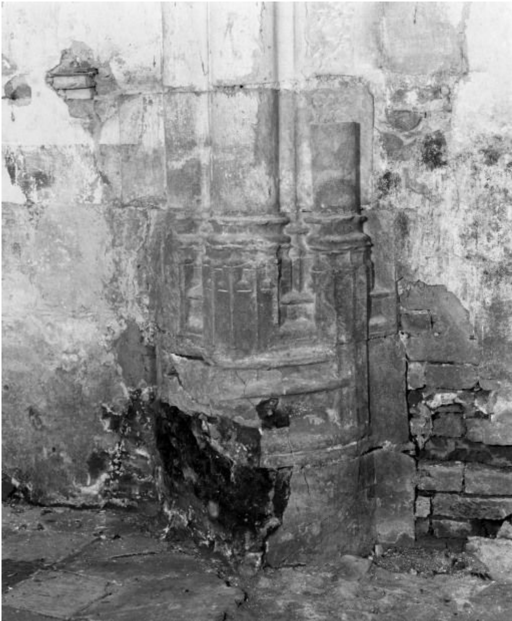
Chapelle de l'ancien château : base des colonnettes à droite, entre les 3e et 4e travées de la nef.
