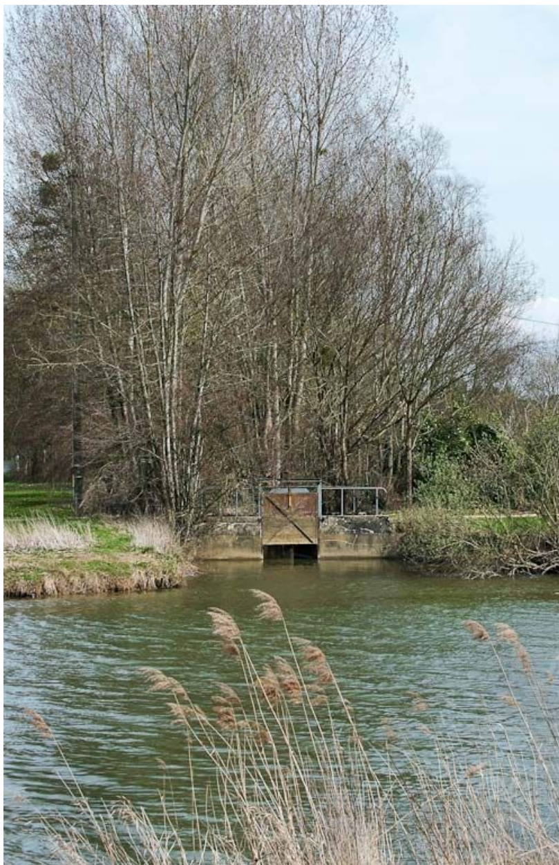
Vue d'ensemble : vanne.
