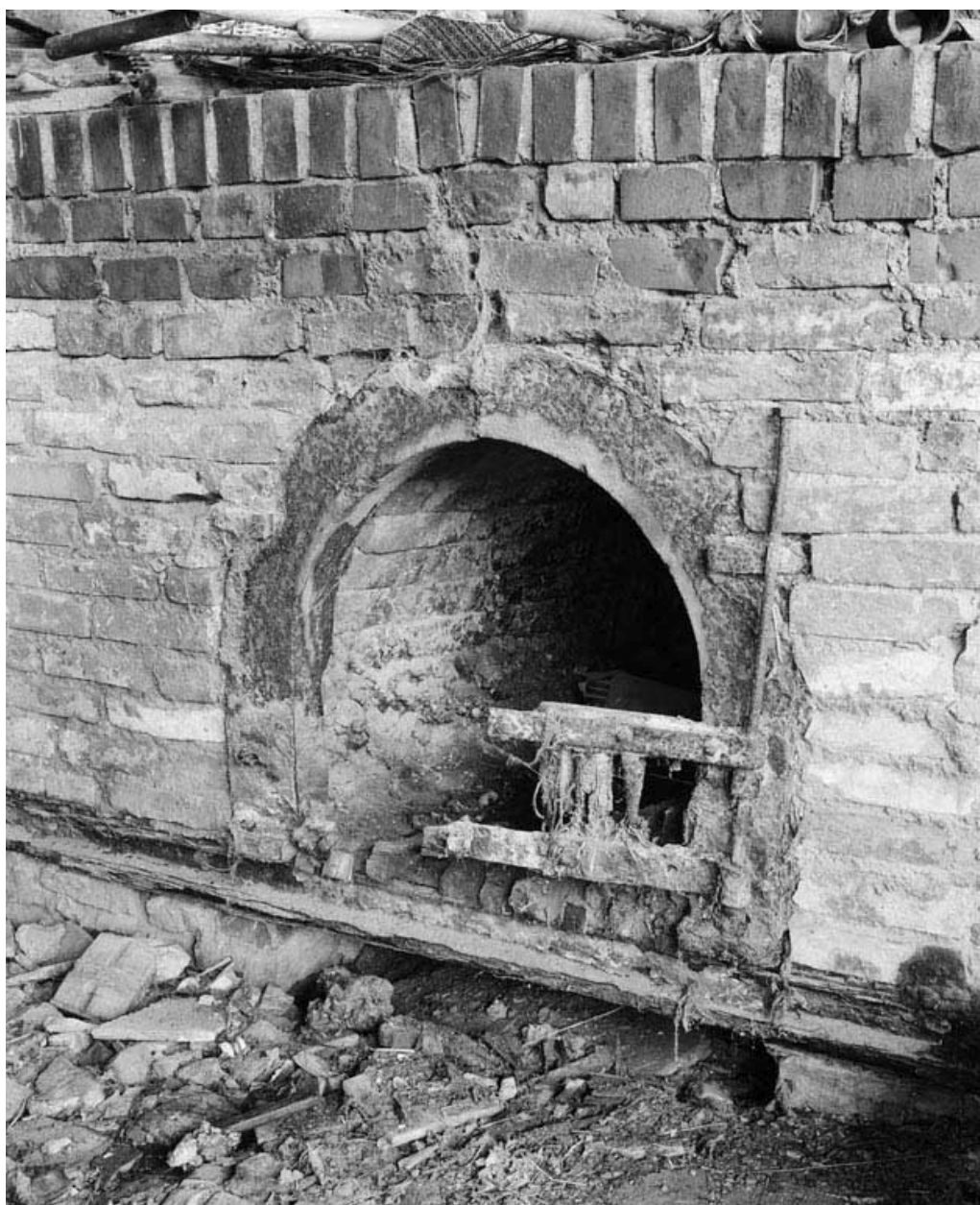
Détail du four : bouche d'enfournement du bois.
