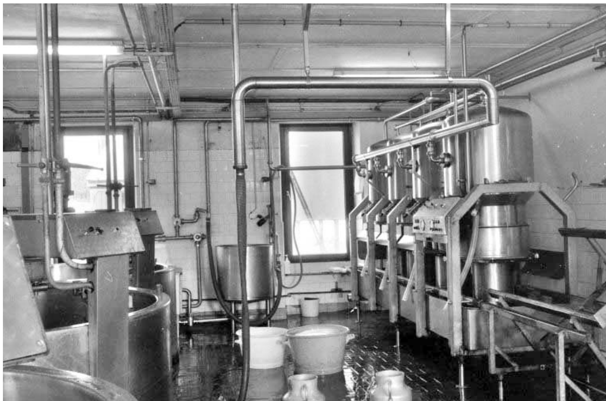
Installation de soutirage.
