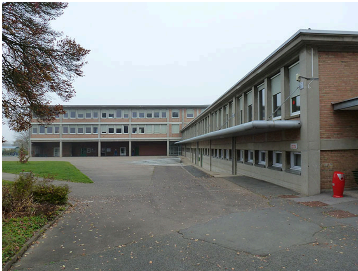
Audincourt, lycée professionnel Nelson Mandela : la cour, les façades antérieures et le préau de l'externat avant les travaux.
