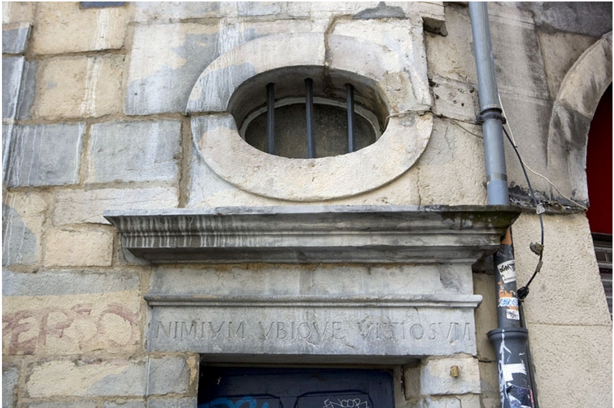
Détail du linteau de porte avec inscription du logis secondaire, rue des Boucheries.
