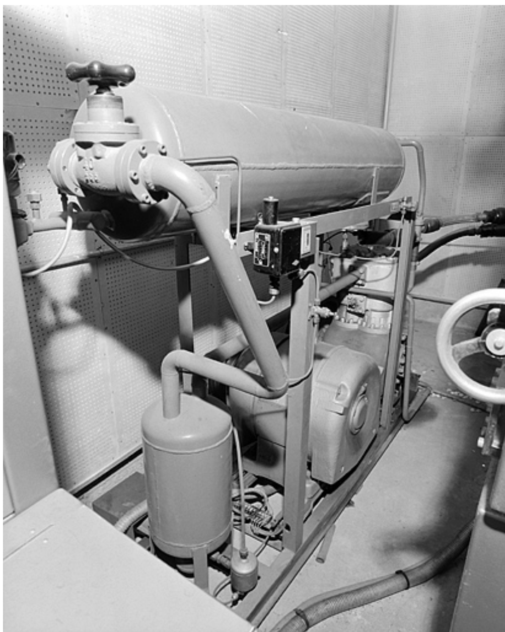
Groupe compresseur - pompe à vide.
