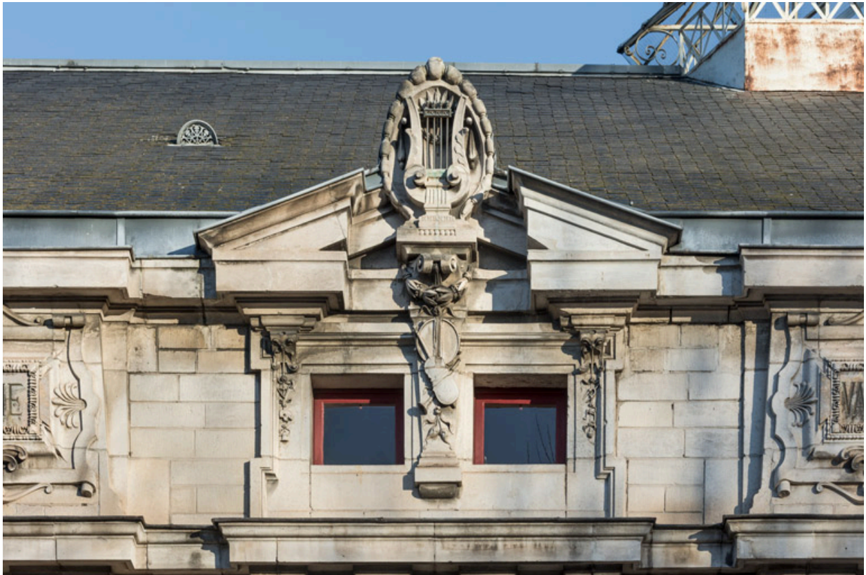
Façade latérale droite, attique : baies et fronton formant l'amortissement de la travée centrale.
