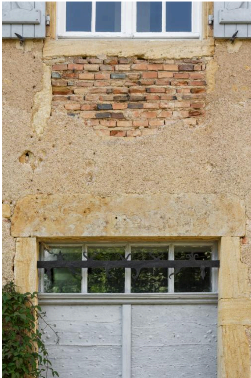
Linteau de la porte de la maison portant la date de 1821 et détail de la maçonnerie en brique sous les assises de fenêtres
