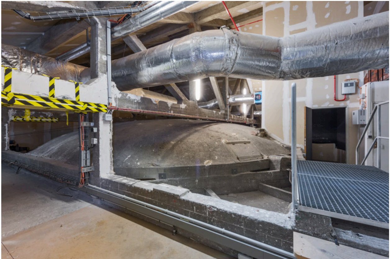
Coupole et charpente en béton armé. La régie est au fond à droite.
