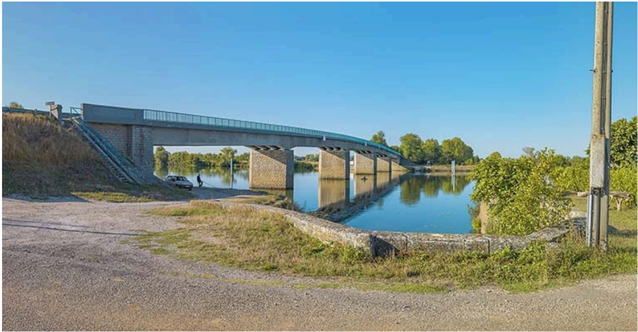
Vue d'ensemble du pont depuis la rive gauche, au niveau du port d'Ouroux.
