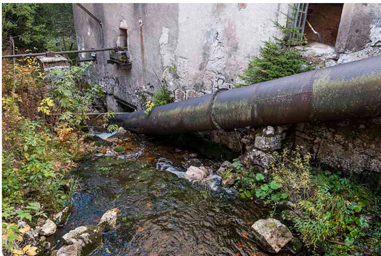
Conduite forcée de la turbine.
