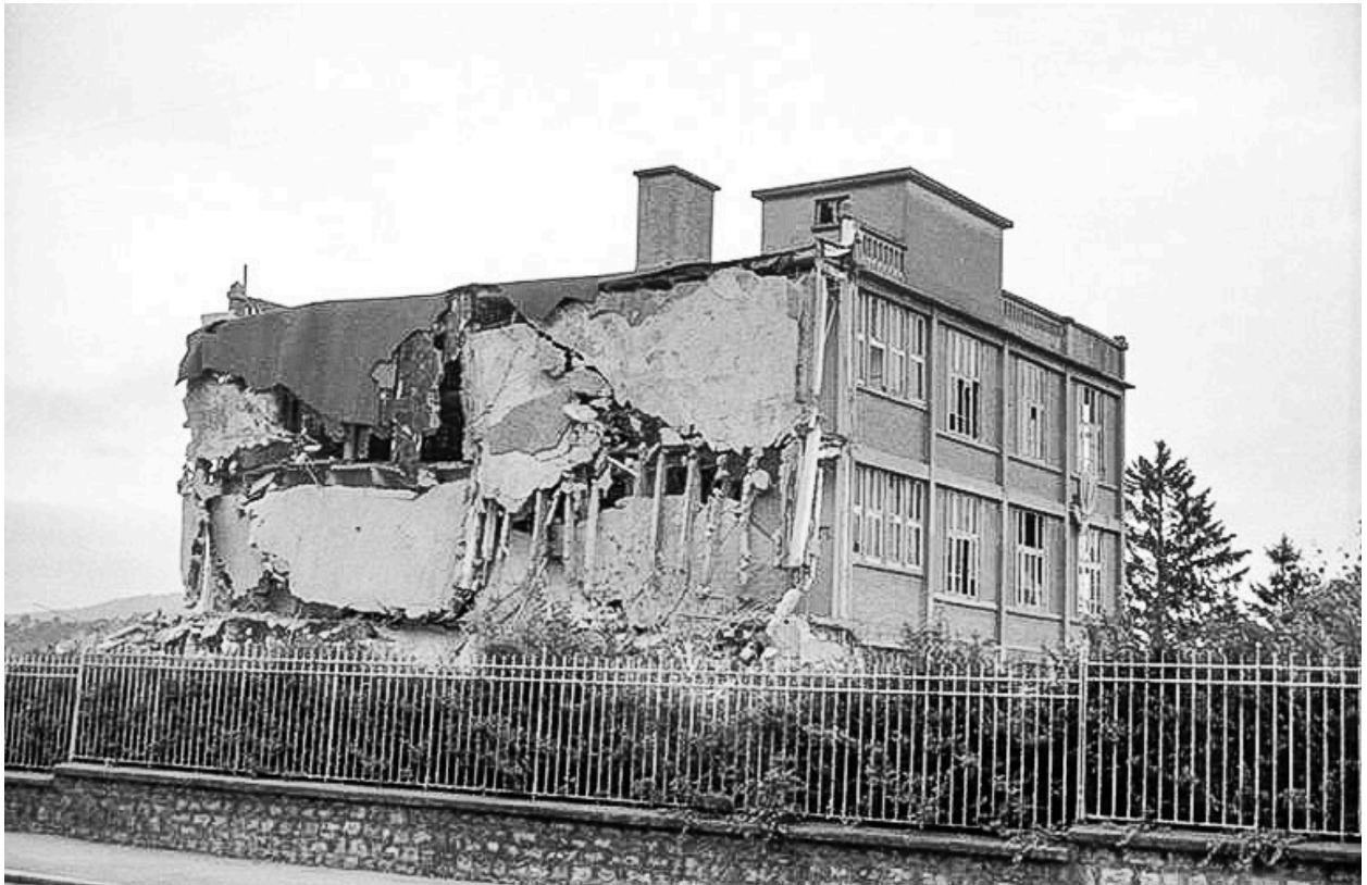
Destruction de l'usine, 22 août 1993 : ateliers (6a, 2a) vus depuis l'ouest.
