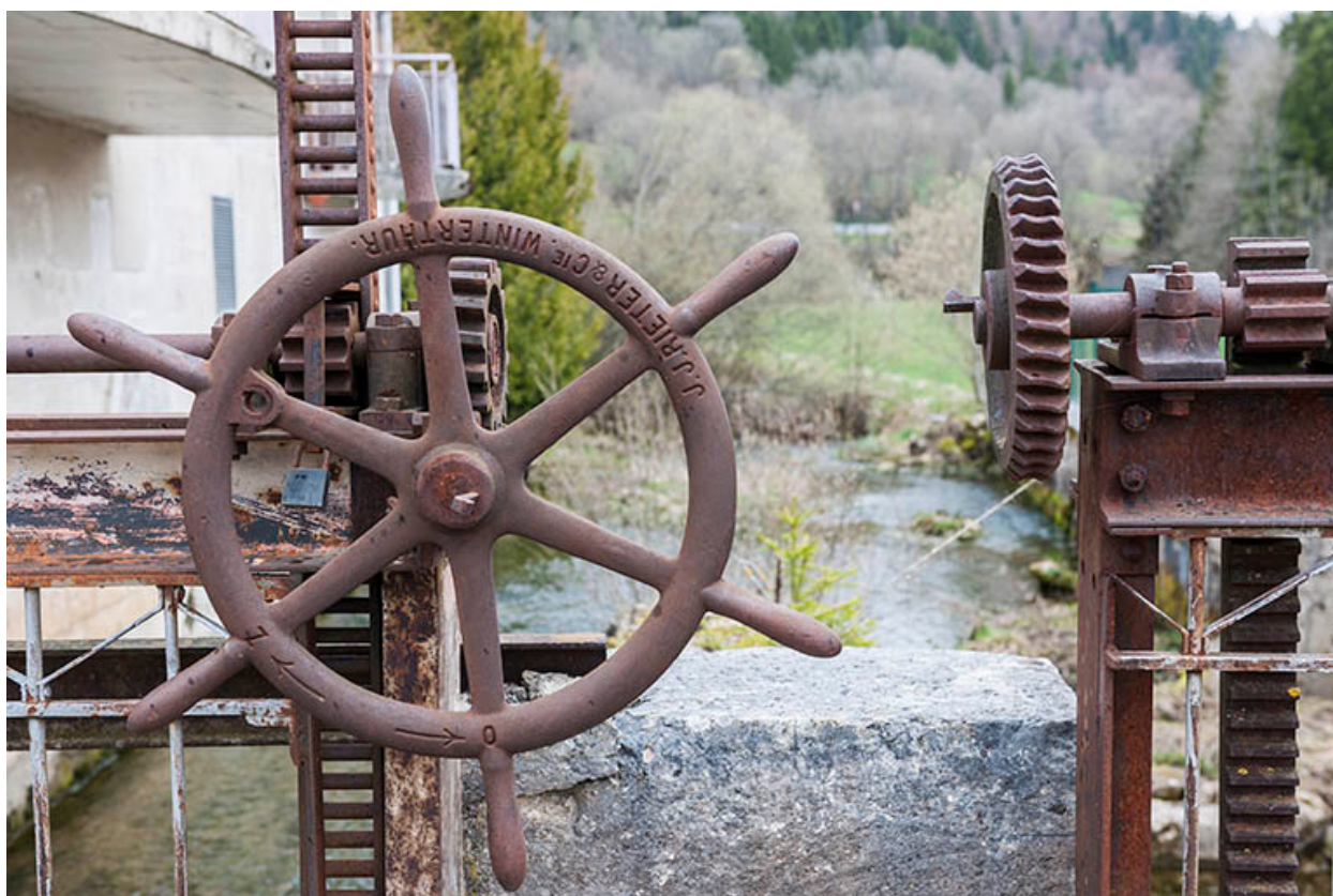
Détail du mécanisme du vannage.
