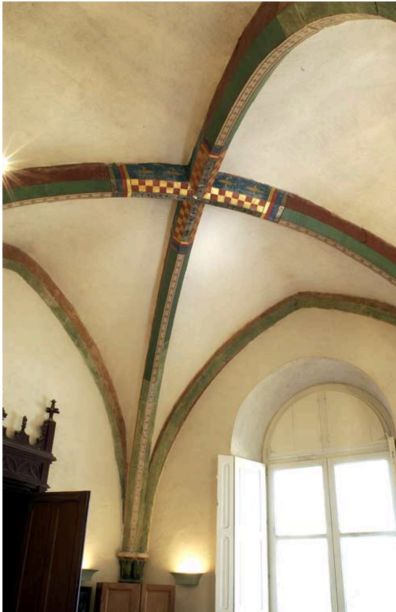
Partie sud de l'aile orientale : salle Garnier II de Sombernon : détail de la voûte d'ogives à décor peint.
