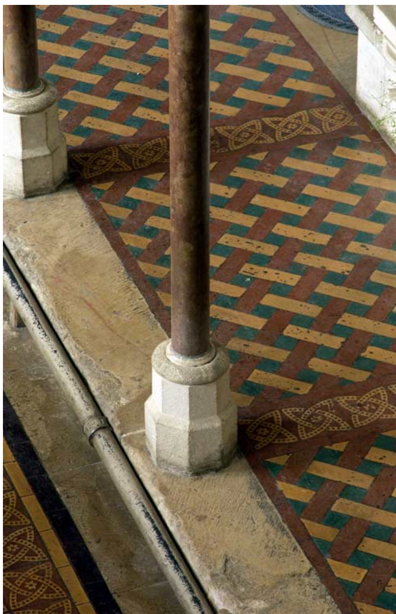
Bâtiment du réfectoire : carrelage de la galerie basse (moitié sud du bâtiment).
