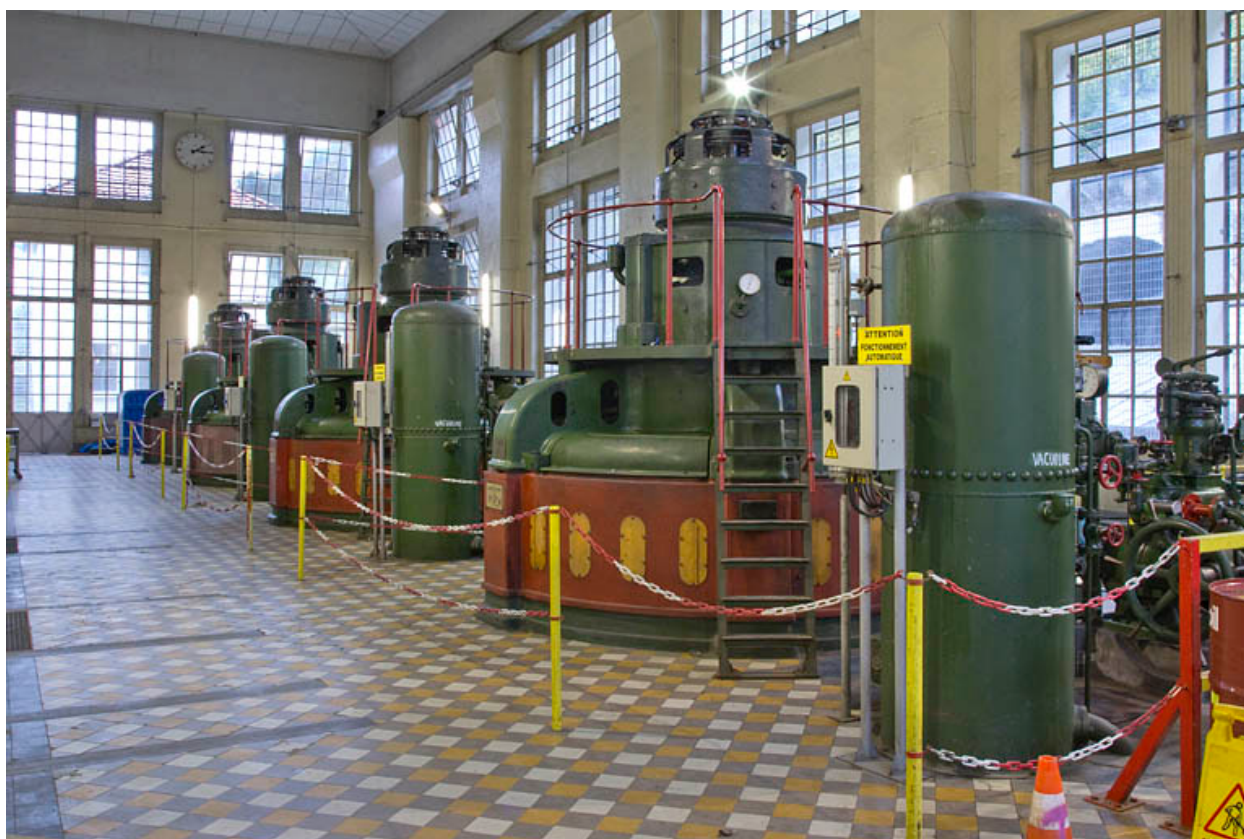
Centrale : vue d'ensemble des groupes (n° 1 à 4).
