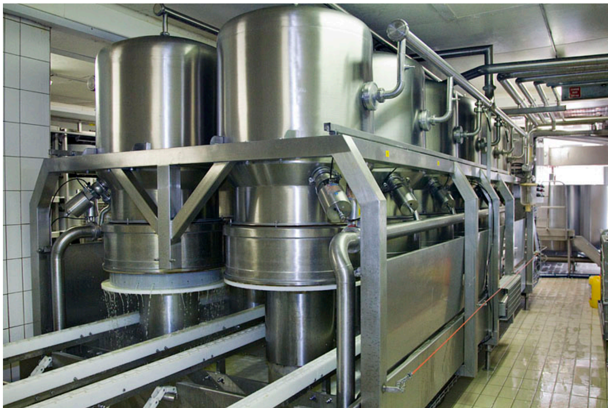
Fabrication du comté : installation de soutirage (face arrière).
