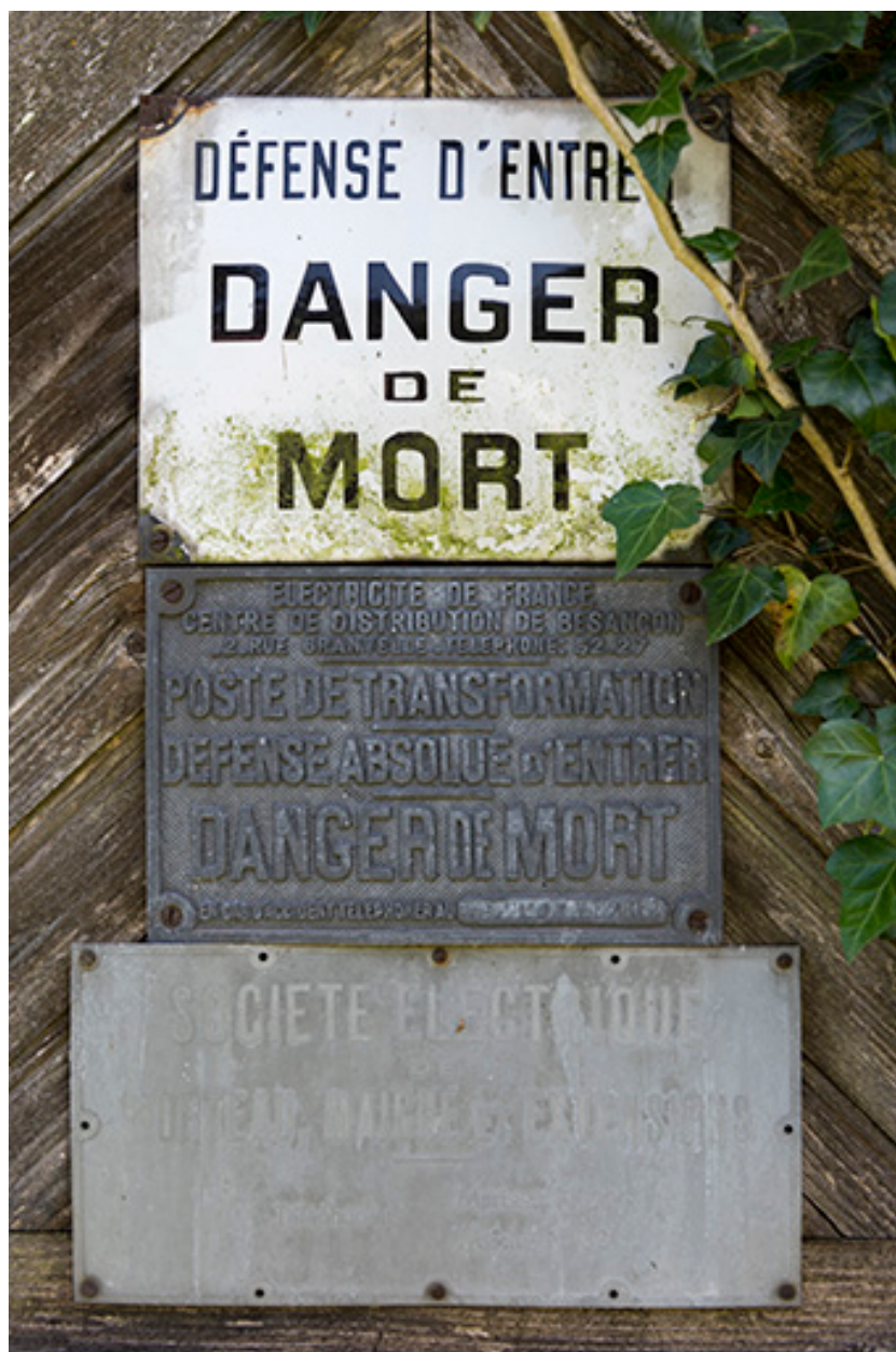
Les Gras : plaques sur le transformateur de la Société électrique de Morteau, Maïche et Extensions.
