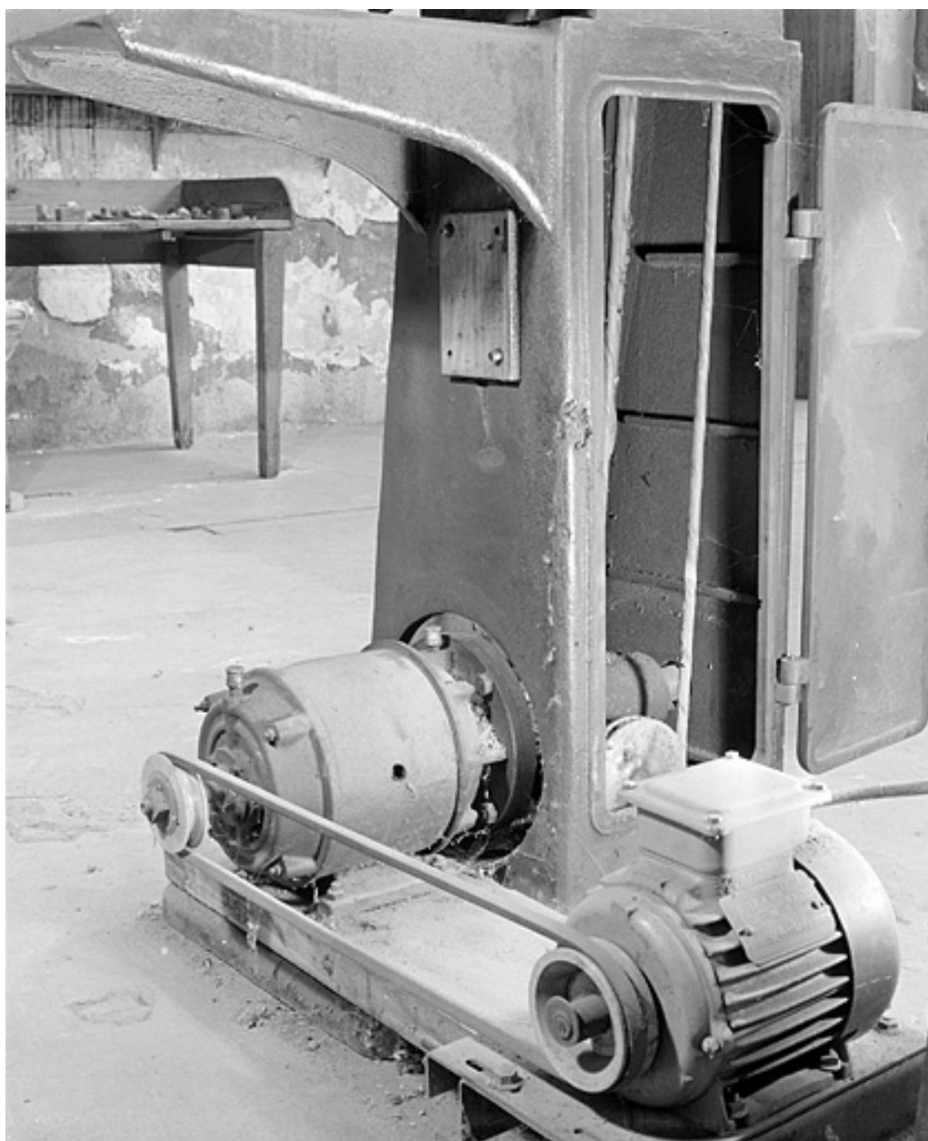
Vue des deux moteurs couplés.
