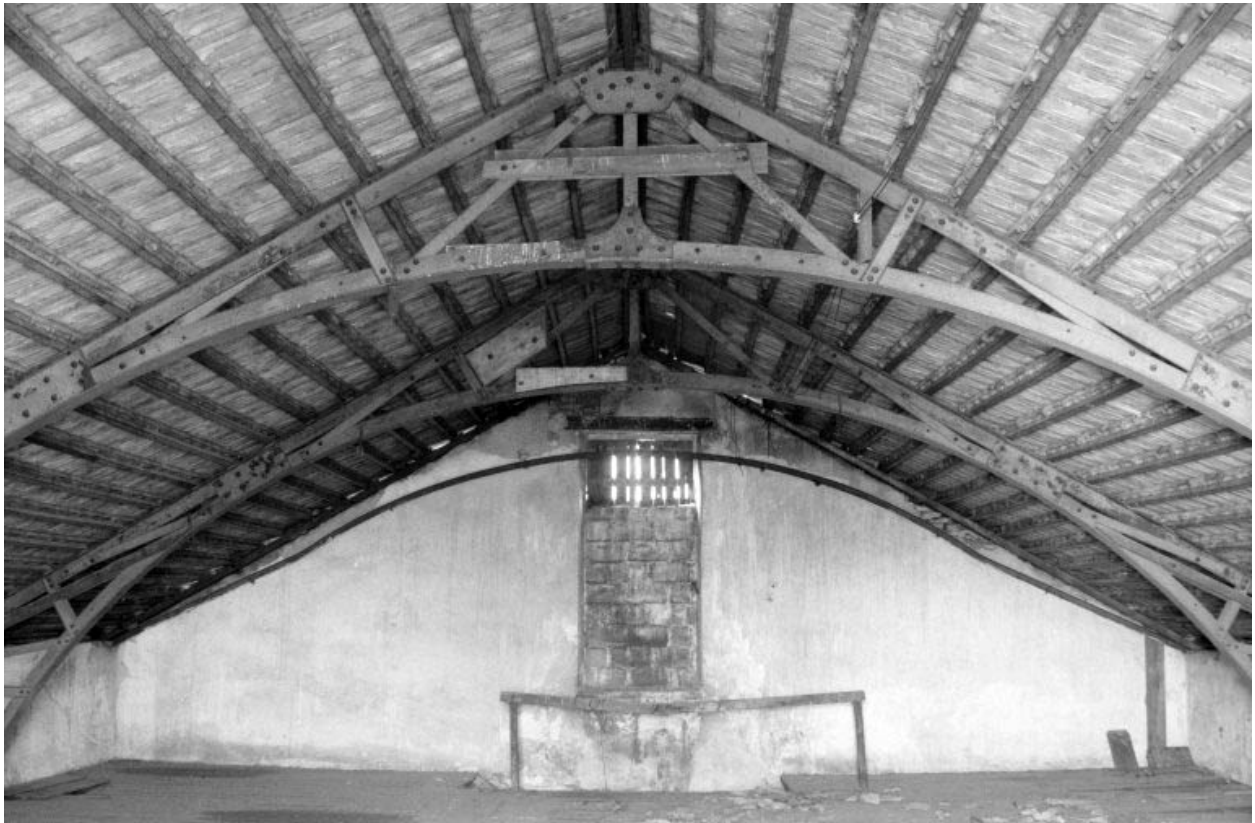
Ancien atelier de fabrication (b2), étage en surcroît : détail de la charpente et mur pignon ouest.
