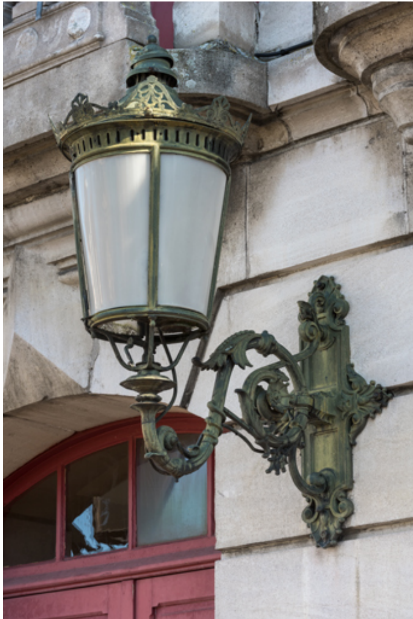
Luminaire d'applique en façade.
