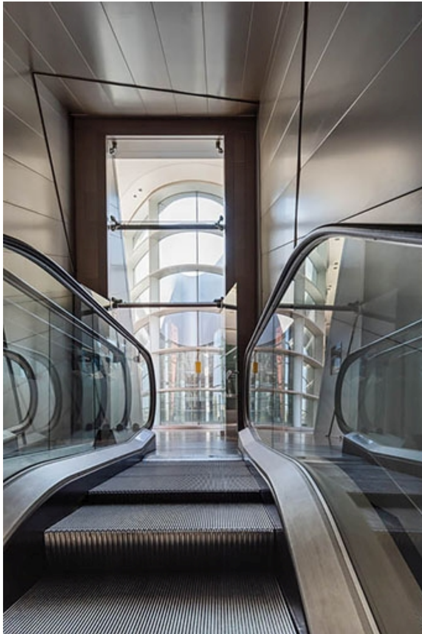
Escalier mécanique principal : arrivée dans le hall.
