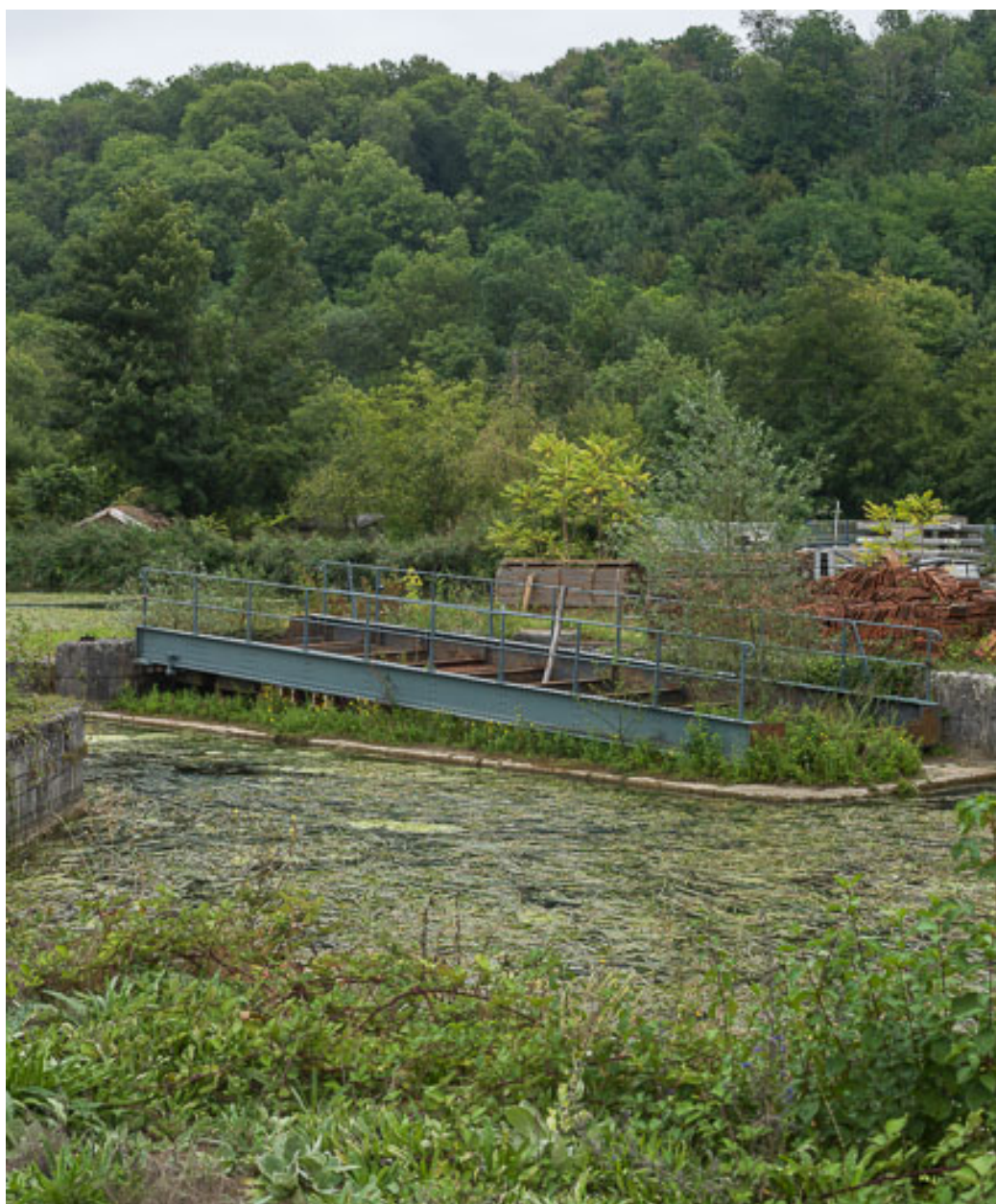
Vue du pont, à l'abandon.
