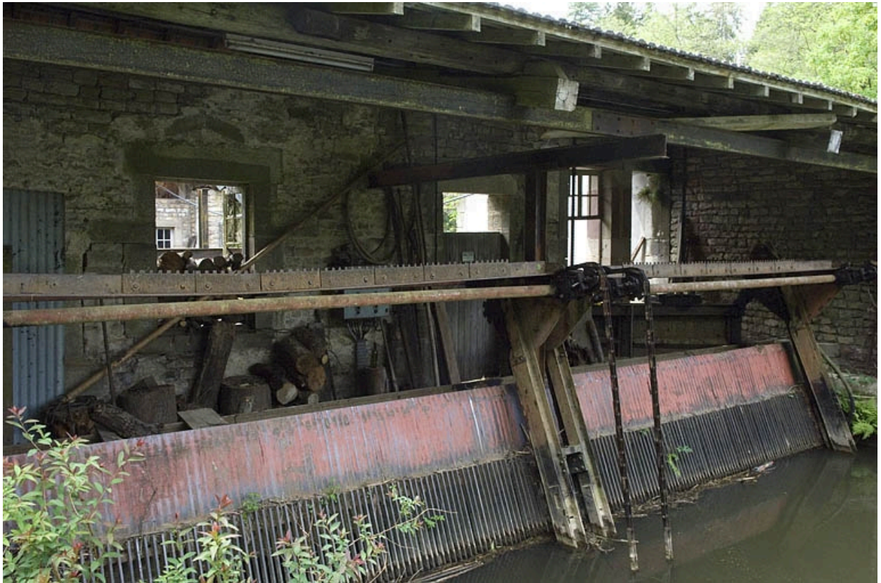
Grille de nettoyage à l'extrémité du bief d'amenée.
