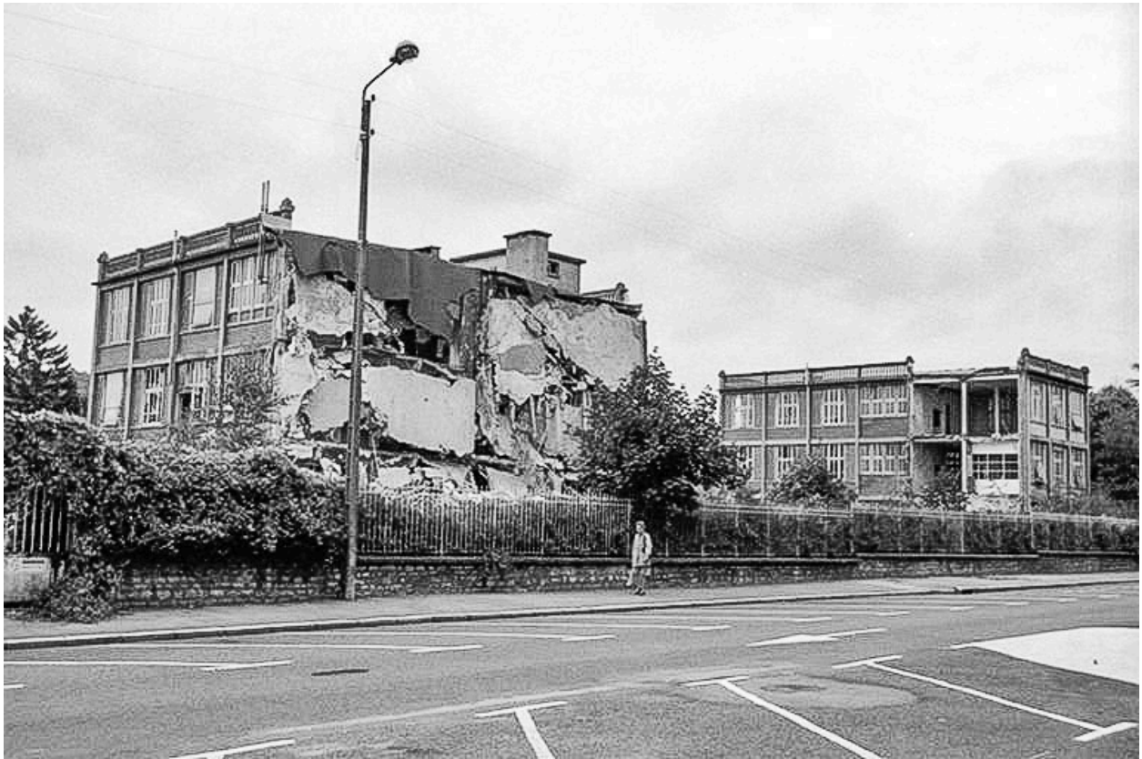
Destruction de l'usine, 22 août 1993 : ateliers (6a, 2a, 2c) vus depuis le nord.
