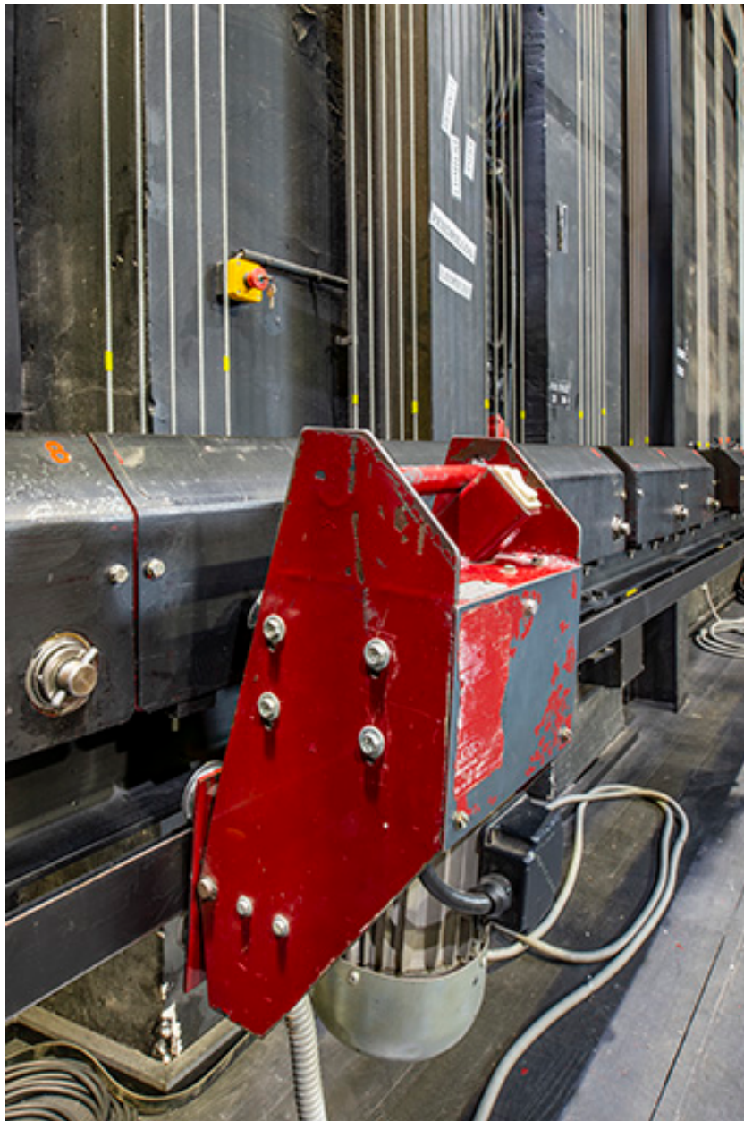
Salle, mur latéral nord-ouest, moteur permettant de faire descendre les cintres.
