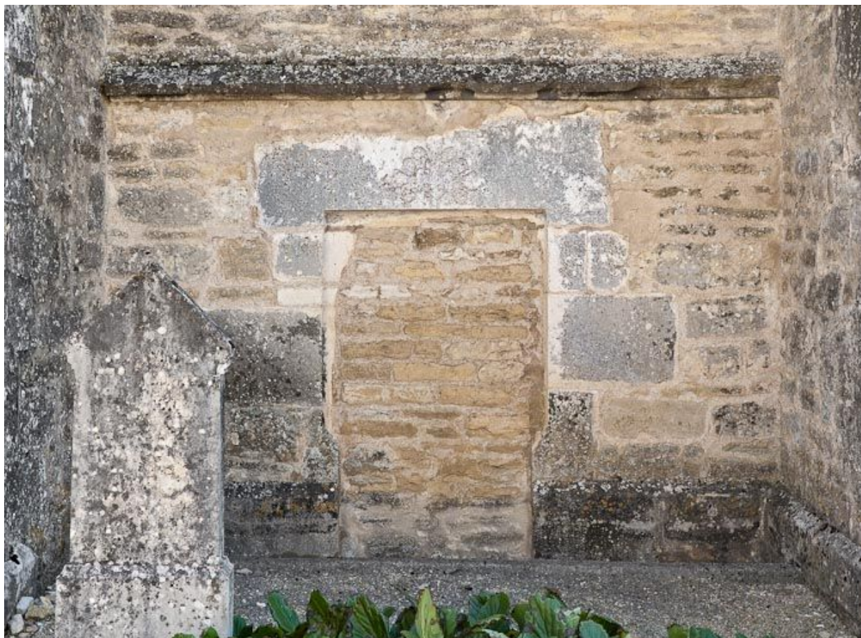
Porte latérale gauche murée.
