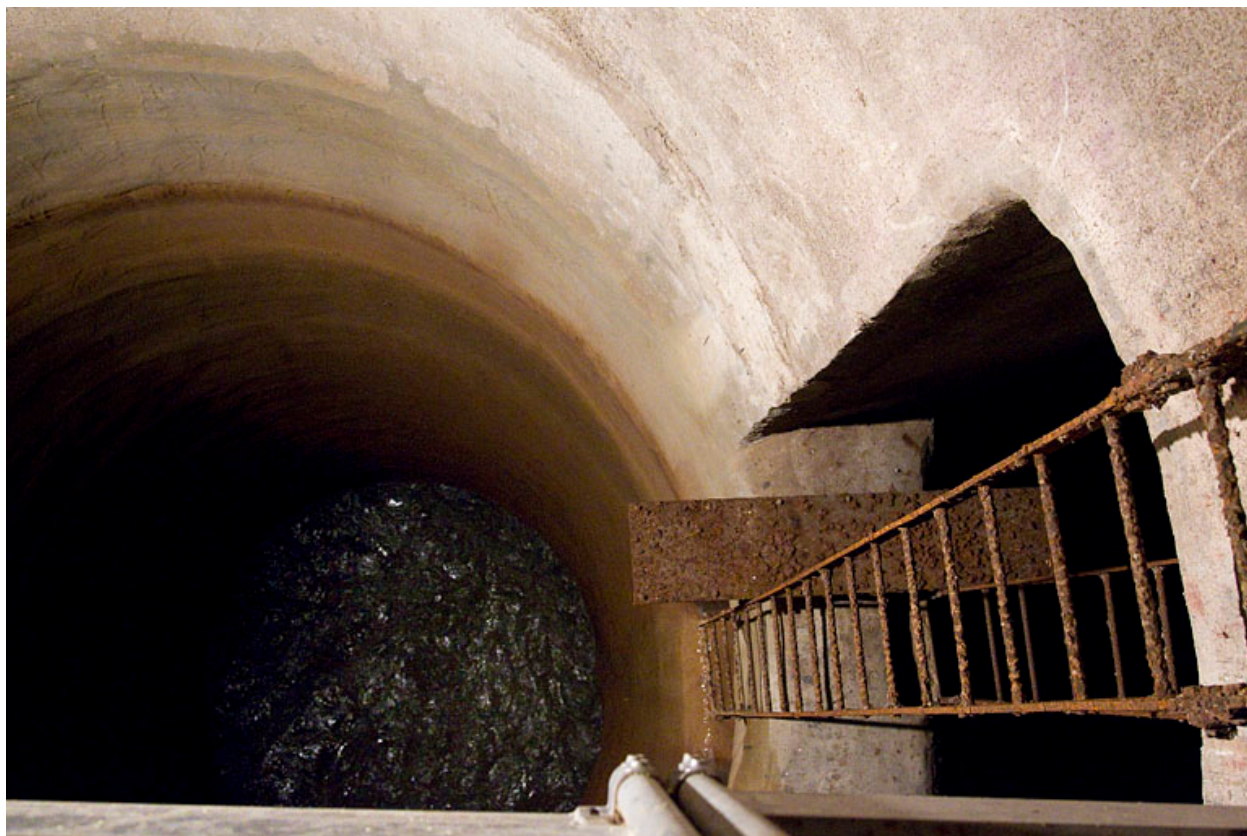
Tunnel d'amenée d'eau : cheminée d'équilibre.
