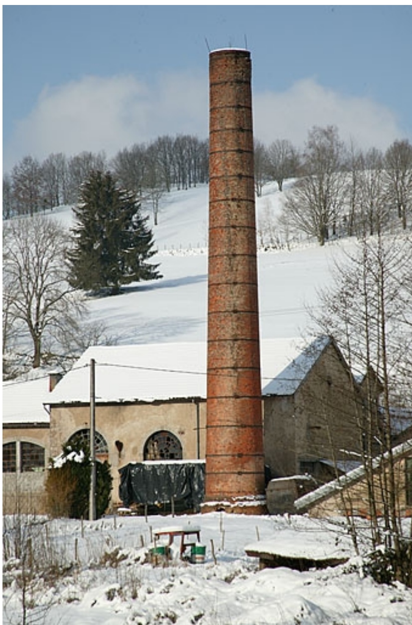
Salle des machines et sa cheminée.
