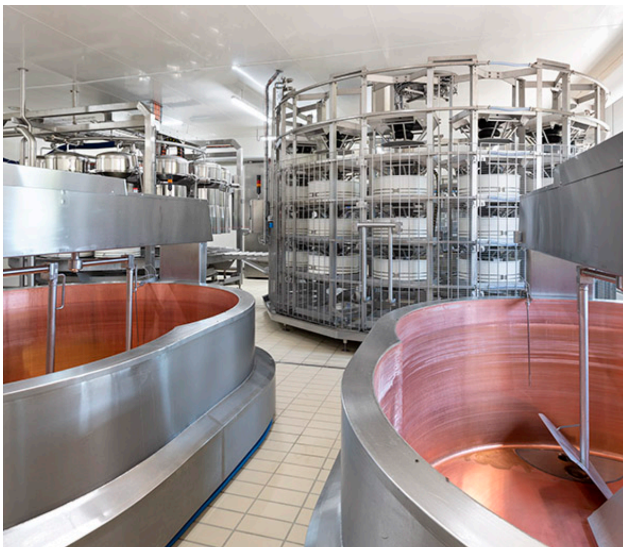
Installation de pressage, vue depuis les cuves.
