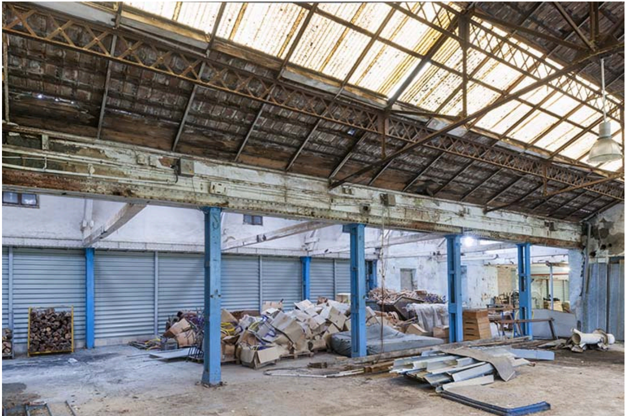
Atelier d'usinage. Vue intérieure de trois quarts.
