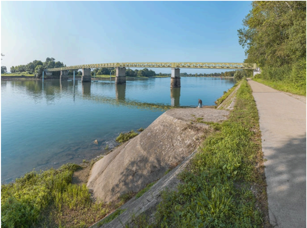
Vue d'ensemble du pont d'amont et depuis la rive droite. Perrés et rampe au premier plan.
