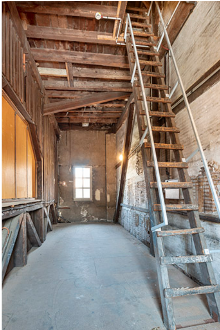
Grand Kursaal : pièce d'accès au comble. Lunette de la fausse-coupole à gauche et escalier desservant le comble à droite.
