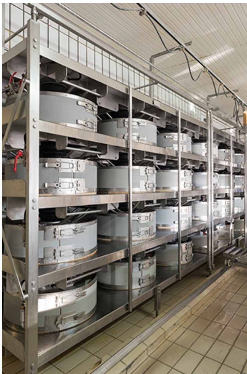
Atelier de fabrication : installation de pressage pneumatique.
