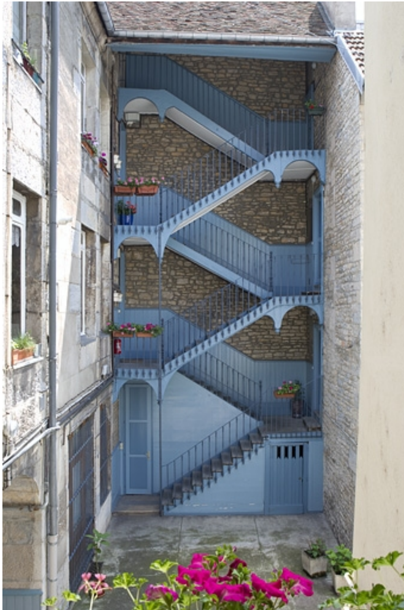
Vue d'ensemble de l'escalier à cage ouverte à gauche de la cour.
