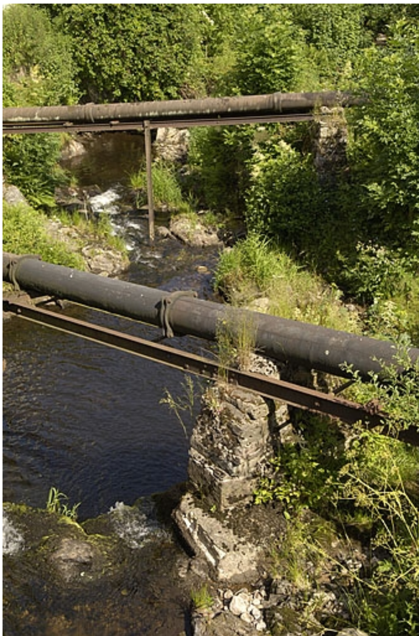
Conduites forcées enjambant le Breuchin.
