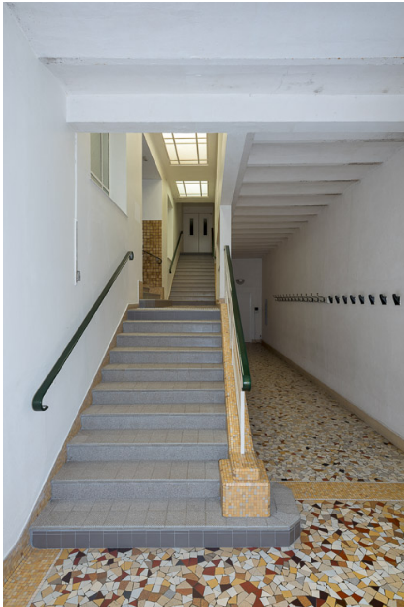
Escalier conduisant du vestibule nord à la salle de pulvérisation des enfants.
