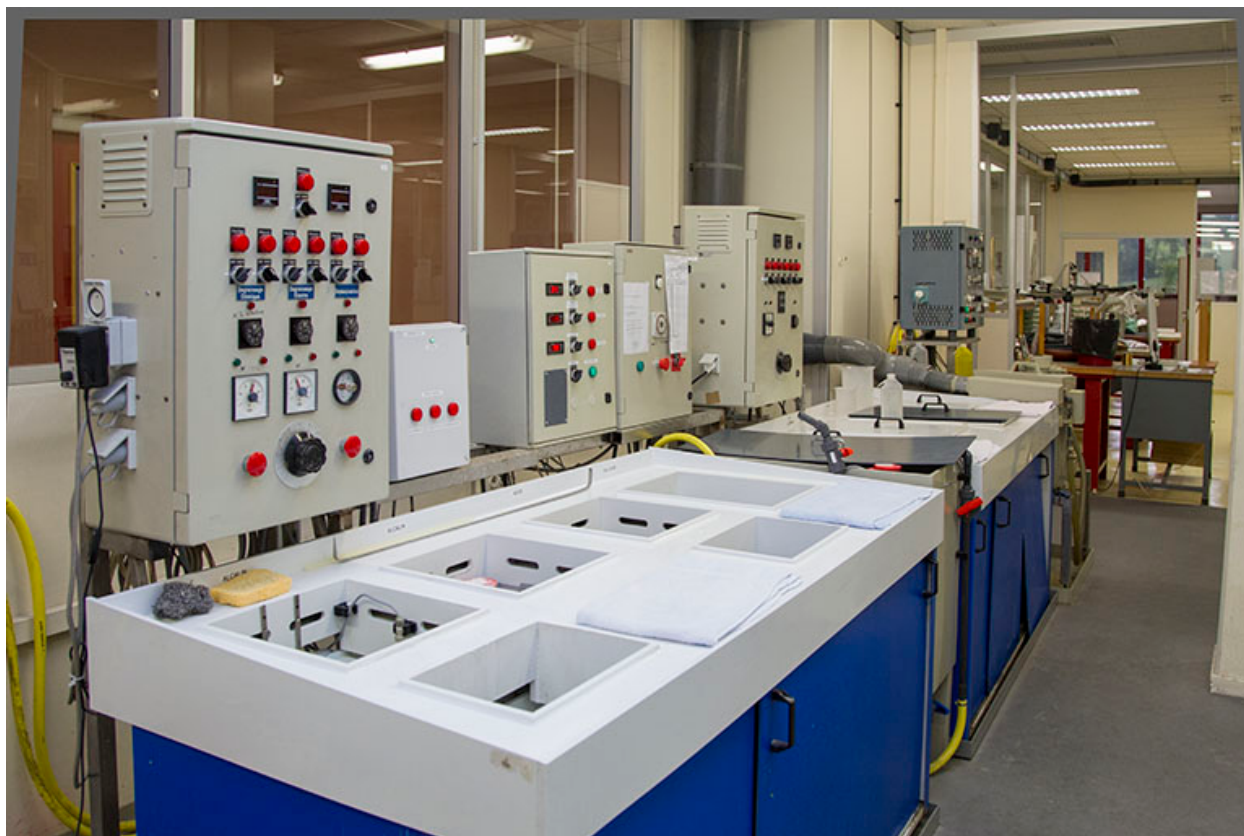
Atelier de traitement de surface : installation de galvanoplastie.
