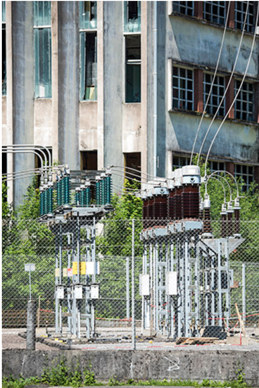
Etat en 2016. Usine A : poste de transformation, à l'est.
