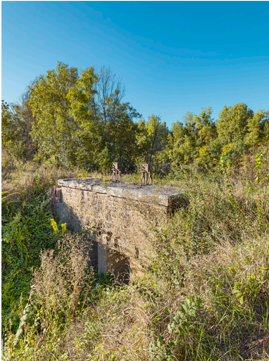
Le système de vannes.
