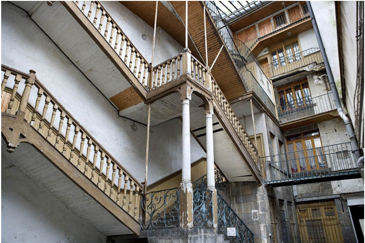
Vue partielle de la façade postérieure du logis principal et de l'escalier à cage ouverte.
