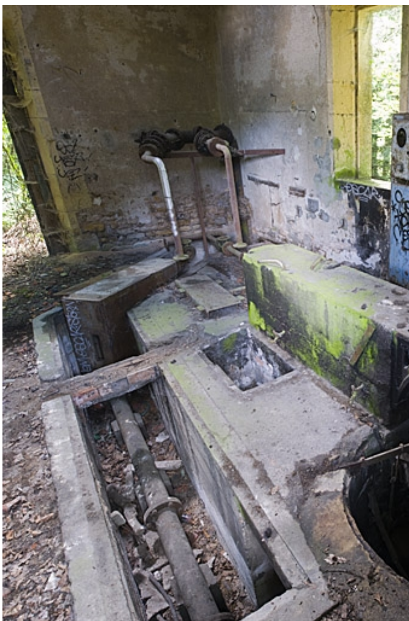
Station de pompage : détail de l'intérieur.
